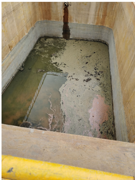
事故缓冲池（应急池）未及时清空
