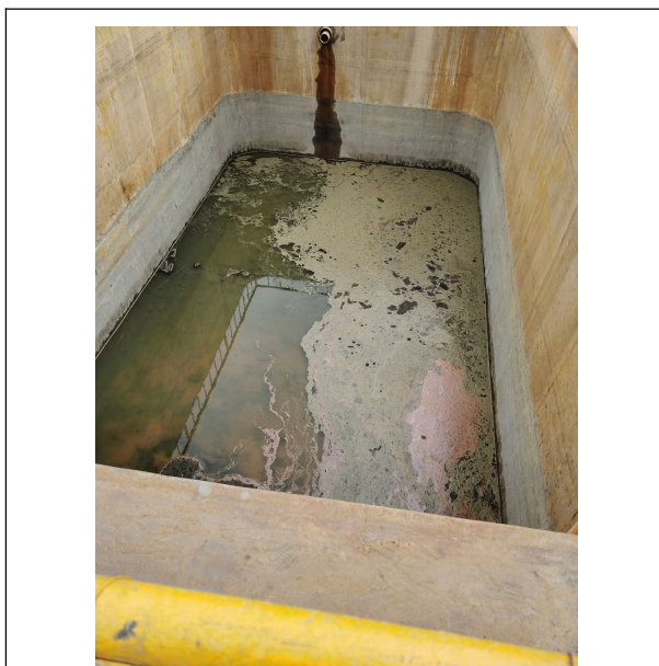
事故缓冲池（应急池）未及时清空
